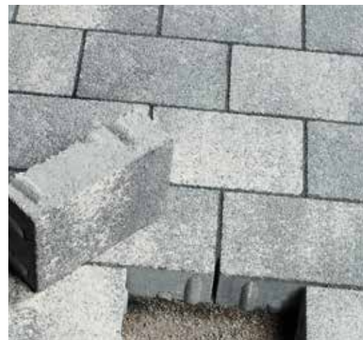
Abb. 33: Das Wasser versickert über die Fuge
