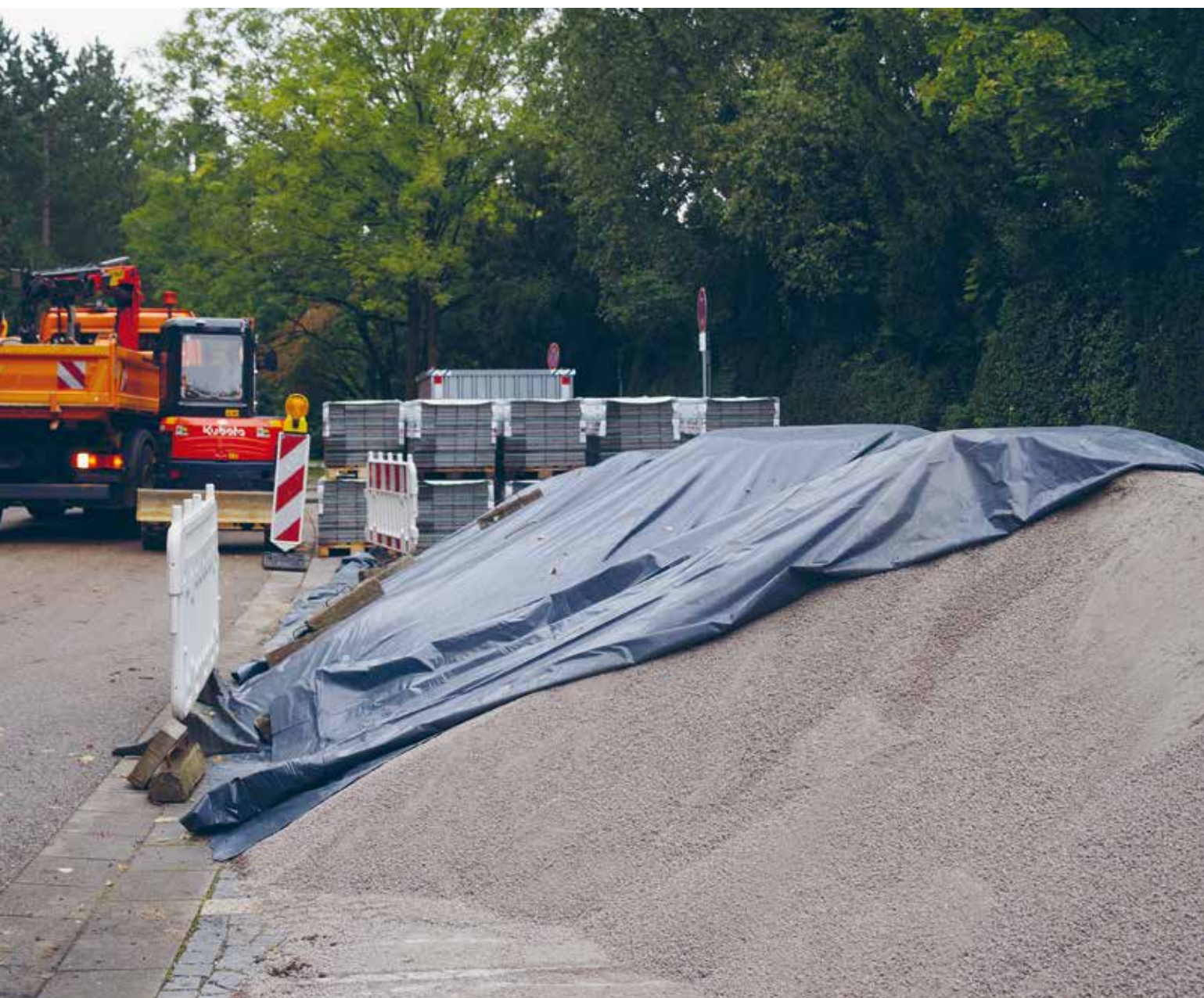
Abb. 44: ECOSAVE protect Bettungs- und Fugenmaterial muss auf der Baustelle vor Entmischung geschützt werden
