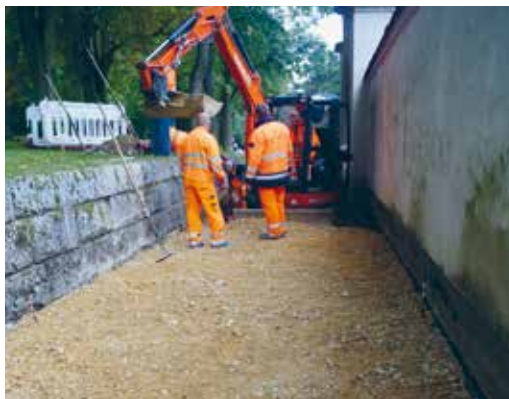
Abb. 53: Der alte Oberbau ist in der Regel zu stark verdichtet
